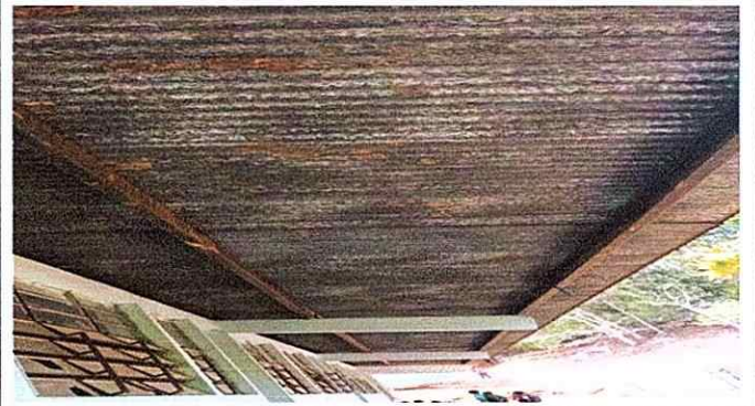
Foto 2. Se observa el deterioro de las costaneras.
