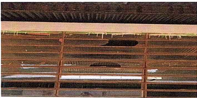
Foto 5. Se observa los vidrios quebrados.
