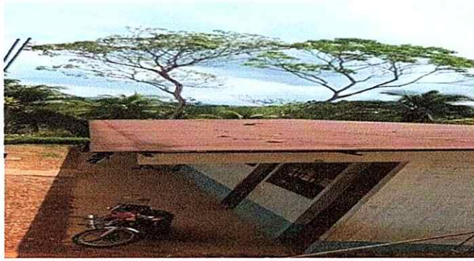
Foto 1. Se observa el deterioro de las láminas.
