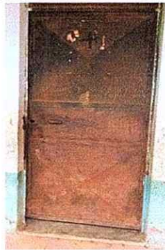
Foto 6. Se observa el mal estado de la puerta.
