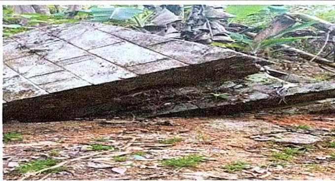
Foto 3. Se observa el hundimiento del baño.
