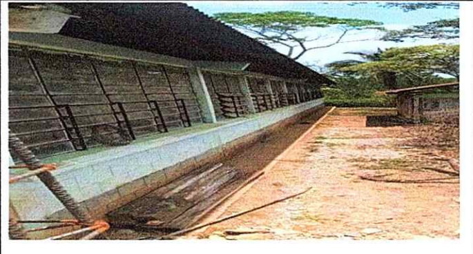
Foto 4. Se observa los vidrios en mal estado.
